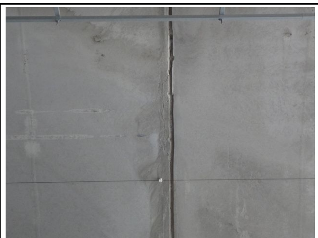
천단부 J60 조인트부 콘크리트 들뜸
