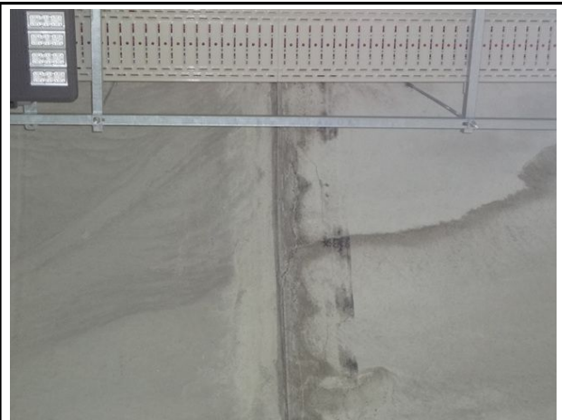
천단부 J33 조인트부 콘크리트 들뜸
